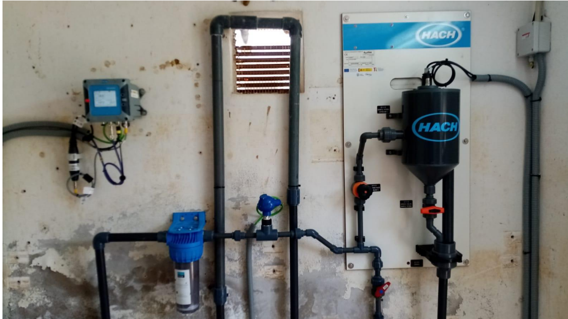
Figura 1. Instalación de batería analizadora de turbidez, conductividad y temperatura de agua bruta.
