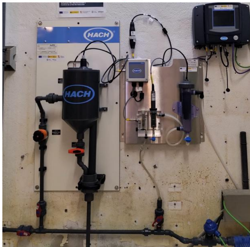
Figura 2. Instalación de sonda analizadora de pH y cloro libre junto a batería de turbidez, conductividad y temperatura.
