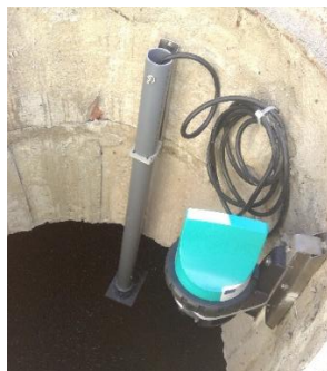
Figura 1. Instalación datalogger con sensor de nivel.
