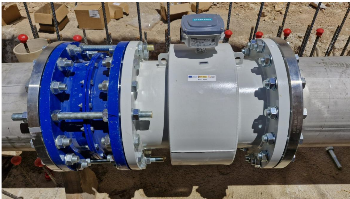
Figura 2. Instalación de caudalímetro electromagnético.
