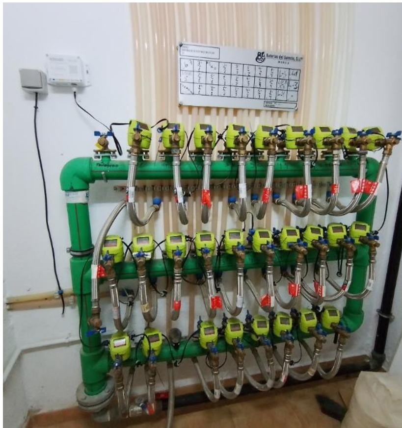
Imagen 2: Ejemplo de instalación típica, donde se puede ver la batería con los conectados entre ellos formando un bus y el equipo NBloT instalado
