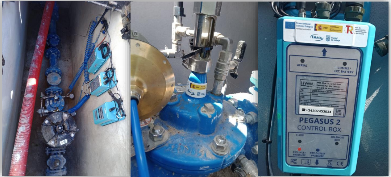
Imagen 1: Ejemplo de instalación típica, donde se puede ver la instalación en arqueta del conjunto VRP + Caudalímetro + Controlador, así como detalles de la VRP y del controlador
